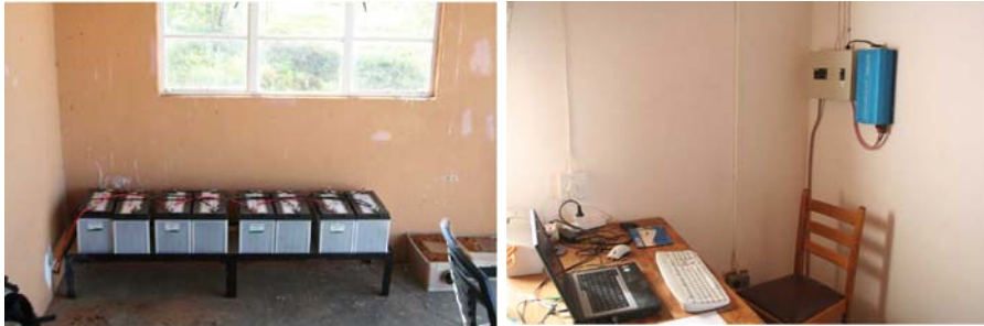
Die Solarpanels speisen die Solarbatterien. Von diesen führt ein Kabel in den blauen Inverter an der Wand im Haus, welcher 24V zu 220V umwandelt. Von hier führen Kabel zu insgesamt acht Steckdosen im Haus, wie der weißen links im Bild, welche den Laptop speist.
