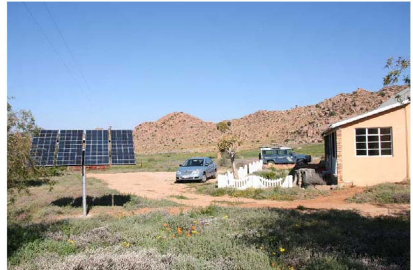
Große Solarpanels versorgen nun die Forschungsstation mit Strom.
